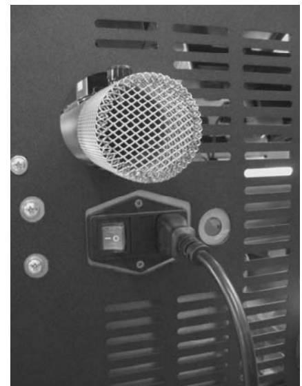
Branchement électrique du poêle
