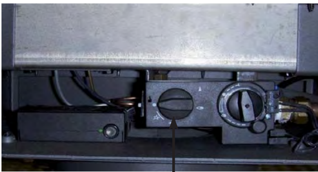
Ontvanger en gasregelblok (A)
