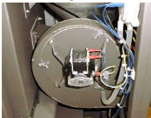
Photo 17: Soufflerie des gaz de fumée et boîtier de la ventilation
