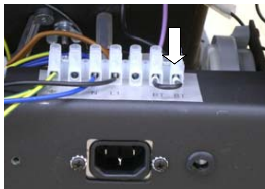
Photo 6: Barrette serre-fils avec pont de câble
