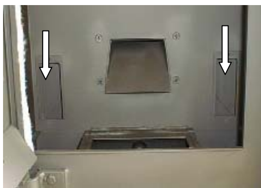
Photo 16: Ouverture de nettoyage inférieur
